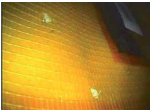
Рис. 3.1.26. Повреждение термозащитного одеяла под панелью радиатора
